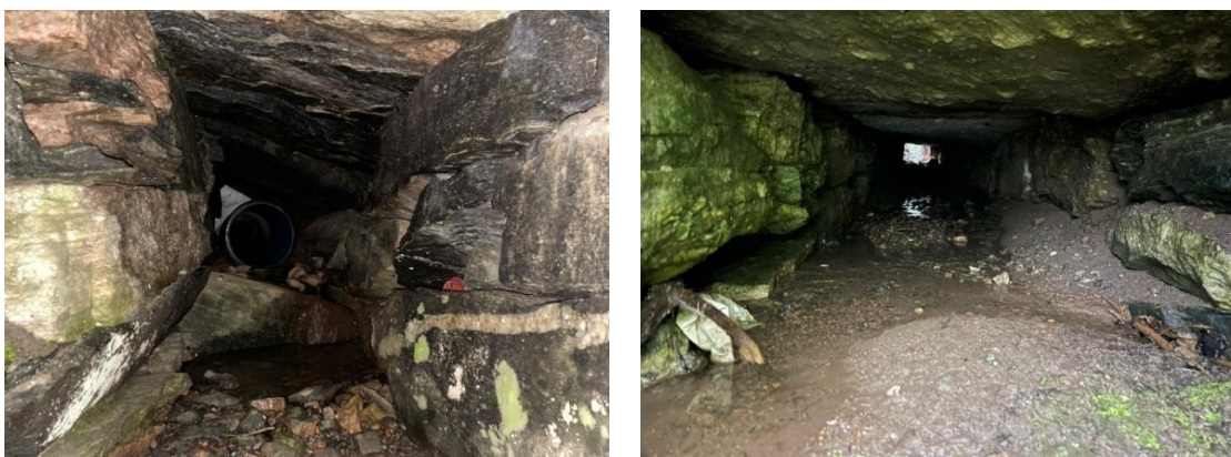
FIGUR 13 KISTEVEIT MED UTLØP AV OVERVANNsledNING (T.V.) OG KISTEVEIT UNDER SØRSTRANDSVEGEN (T.H.)
