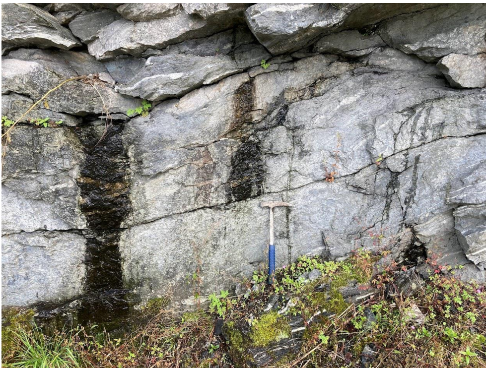
Figur 6-18: Vann renner ut av sprekkene ved lokalitet A3. Bildet er tatt mot sørøst. Kilde: COWI AS.
