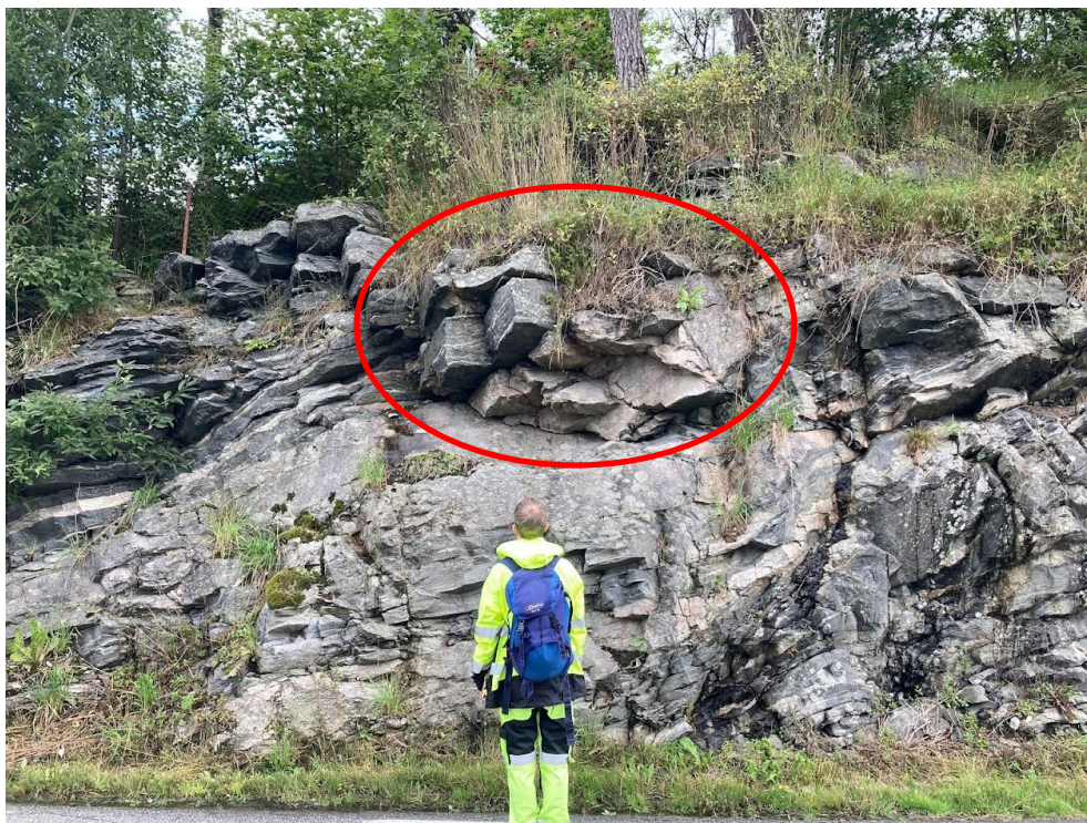
Figur 6-28: Bloksamling med mulig avløsende sprekk på S3 ved lokalitet A1. Bildet er tatt mot øst. Kilder: COWI AS.
