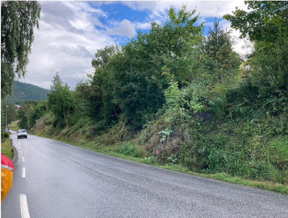
Figur 6-15: Bratt terreng med mye vegetasjon og usikkert grunnforhold ved lokalitet A8. Bildet er tatt mot øst. Kilde: COWI AS.
