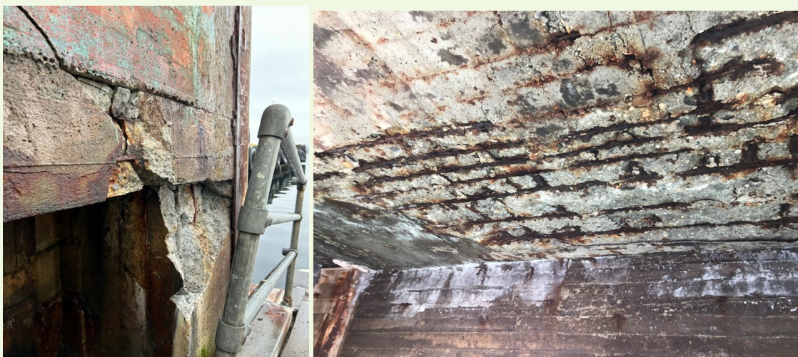
Figur 6 - Bilda viser skada betong og armering (kjelde: Vestland fylkeskommune)
