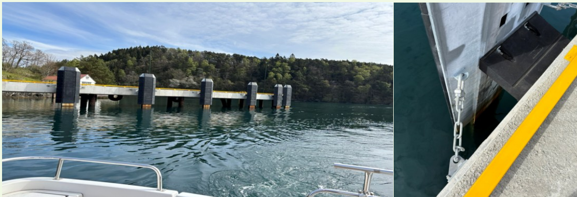
Figur 4 -Bilda viser kai med god fending (fenderpanel), noko som hindrar skade av kai når ferja legg til (kjelde: Vestland fylkeskommune)
