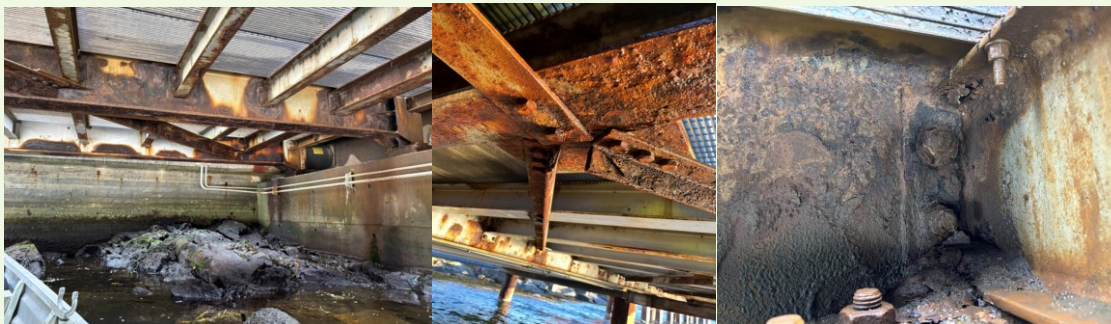
Figur 5 - Bilda viser rustskadar på ferjekaibru som medfører reduksjon i materialtjukkuleik (kjelde: Vestland fylkeskommune)
