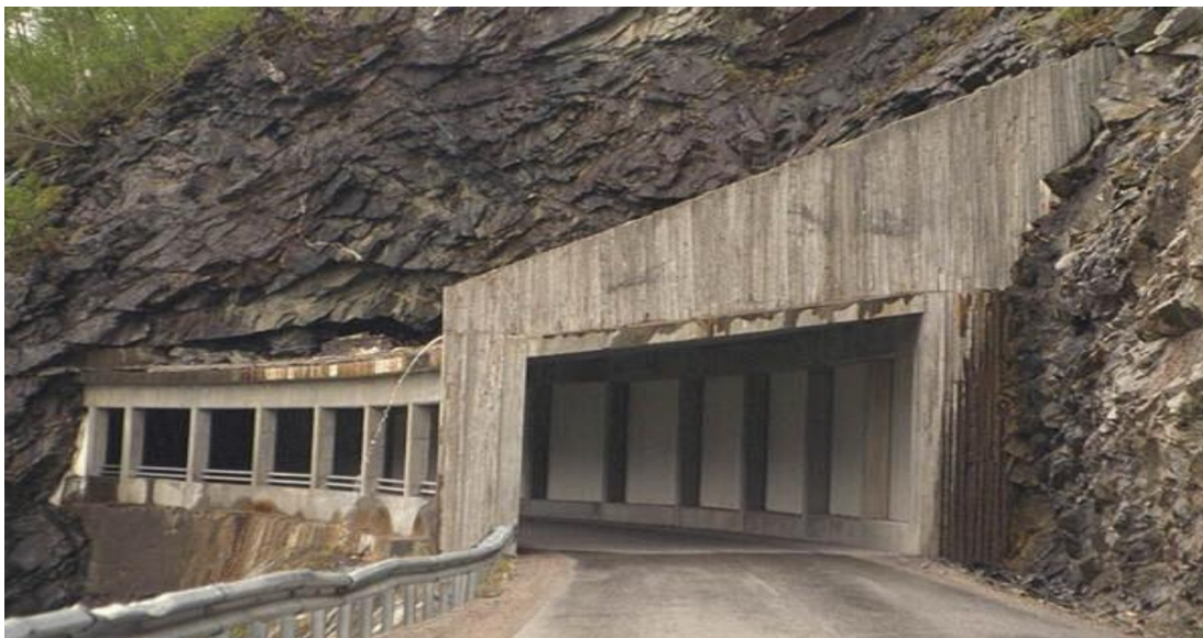
Figur 4-2: Rasoverbygg, langs tidlegare fv. 53 ved Ljoteli i Årdal kommune. Det er bygd ny tunnel som erstattar denne strekinga og det er ikkje lenger trafikk gjennom dette rasoverbygget. (Bruarkiv, Statens vegvesen)
