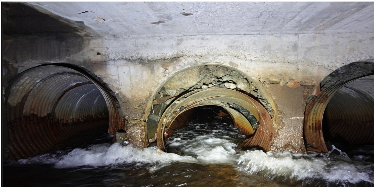
Figur 3-10: Kulvert med røyrsystem ved Osøyro (Vestland fylkeskommune)
